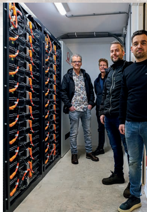
Eigenaren van het bedrijf bij het nieuwe Energie Opslag Systeem v.l.n.r. René van Winkelen, Gert-Jan van Winkelen, Mark Geelhoed en Marijn van Winkelen
